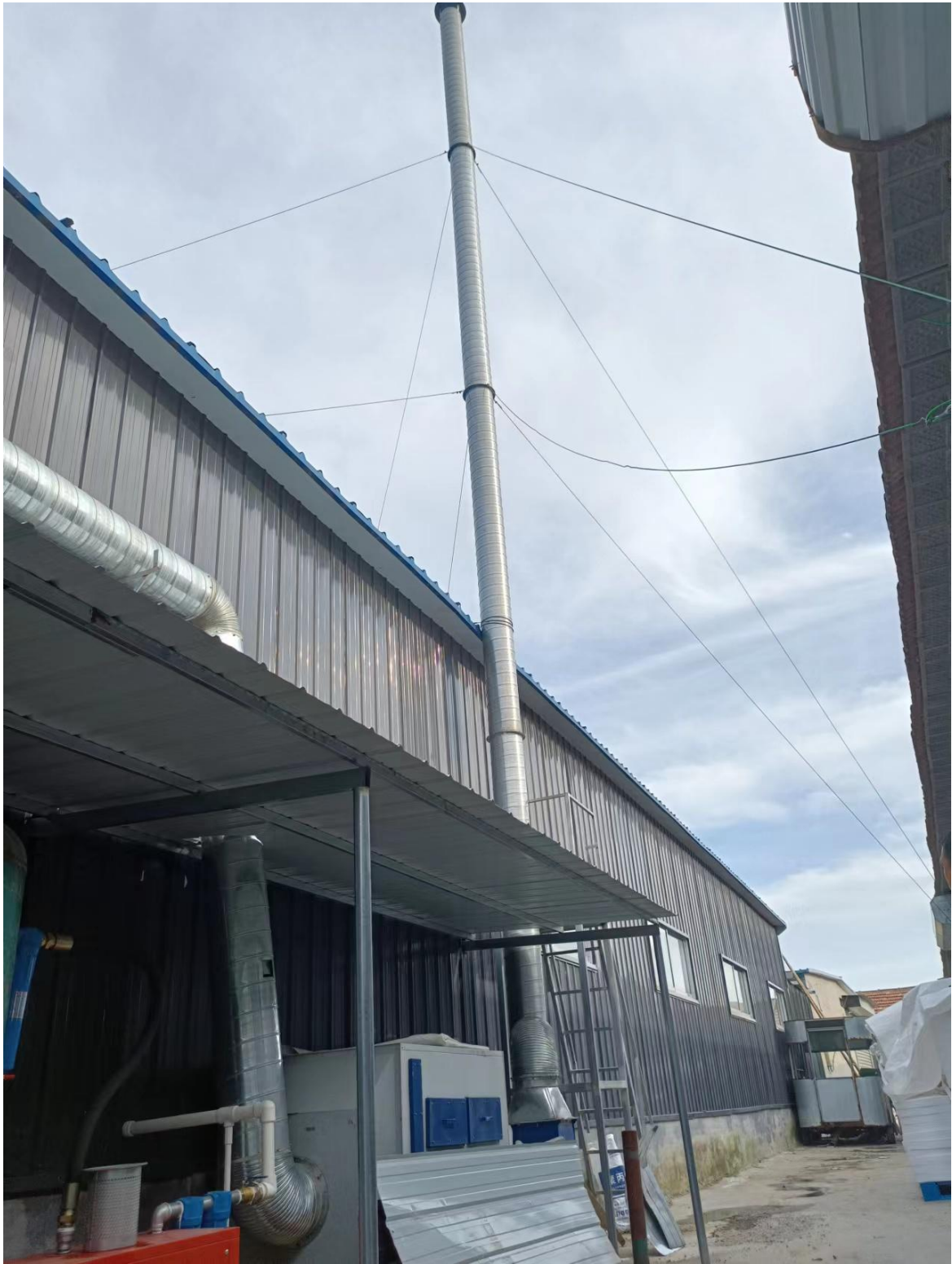
废气处理设备及排气筒
